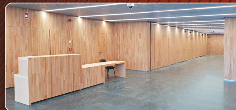
Panelado listones madera
