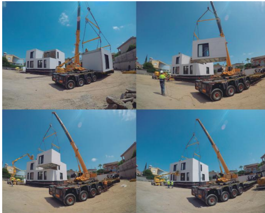
Foto: Secuencia completa de la colocación de uno de los módulos en un chalet pareado
