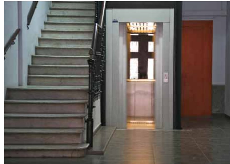
Foto: MP Ascensores
